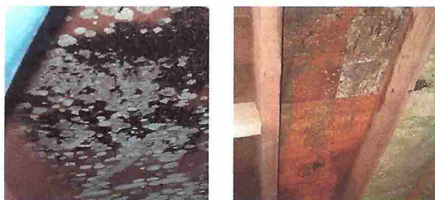
De buitenste laag van de constructie is volledig verwoest door schimmel
