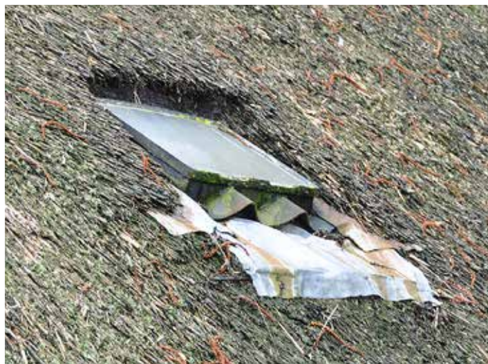
Aan het dakvenster is te zien hoe ver het dak is afgesleten.
