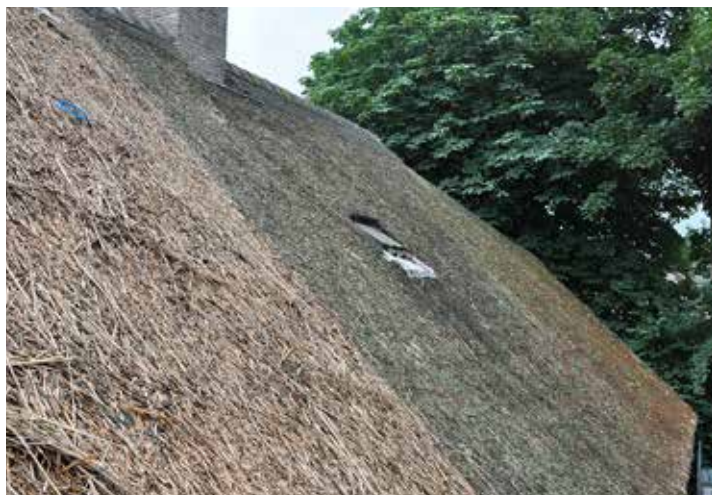
De binding is over het hele dak zichtbaar geworden.
